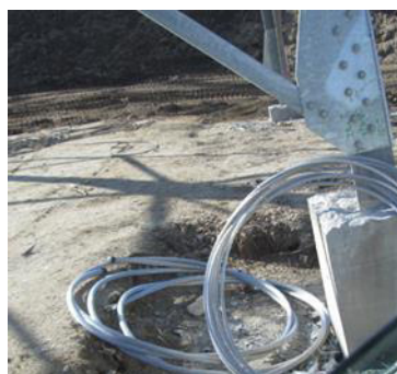
Cabos de aço
